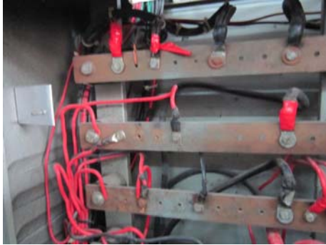
P 29.1 Wiring without lug
