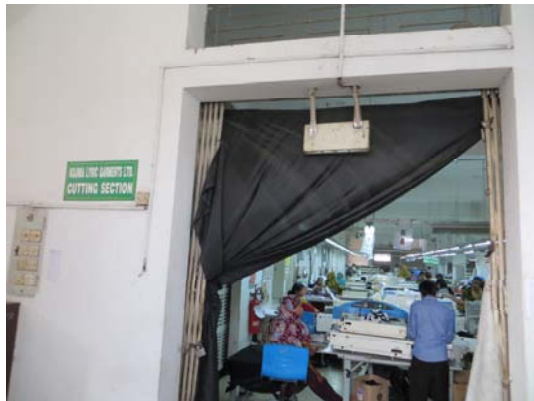
P 11.4 No Fire door
