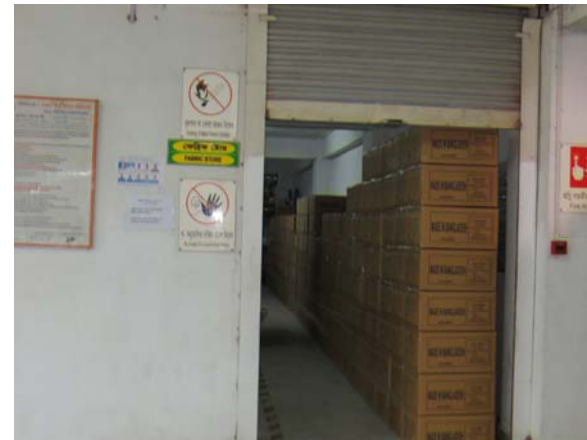
P 12.2 No fire door
